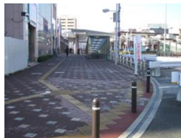
図4-3 転倒事故を起こさせる路面状況のタイル模様の路面やポール付近
