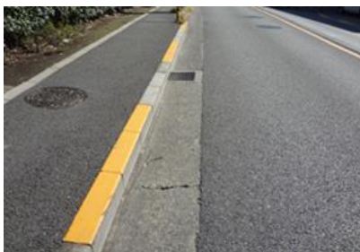
図4-1 転倒事故を起こさせる路面状況で、車道と歩道との間の段差・車道と側溝の境界部・側溝の傾斜・排水用の蓋・表面が曲面のマンホールの蓋
