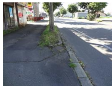
図4-4 転倒事故を起こさせる路面状況で、路面の亀裂
